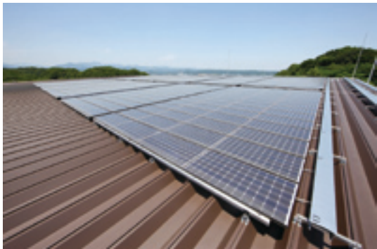
滝山工場の太陽光パネル
