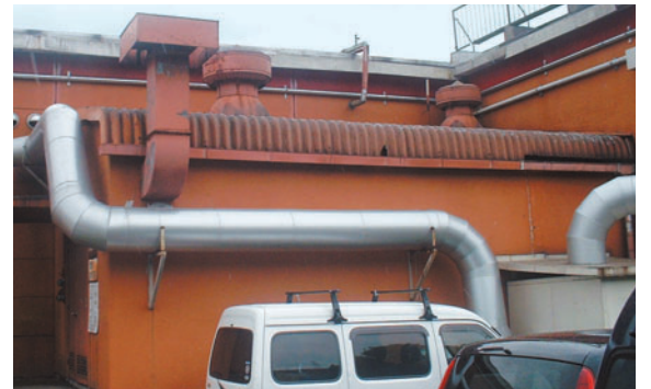
防音カバーでパンチフロアの音を遮断
