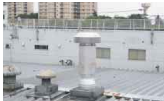
サイレンサー設置の状況
